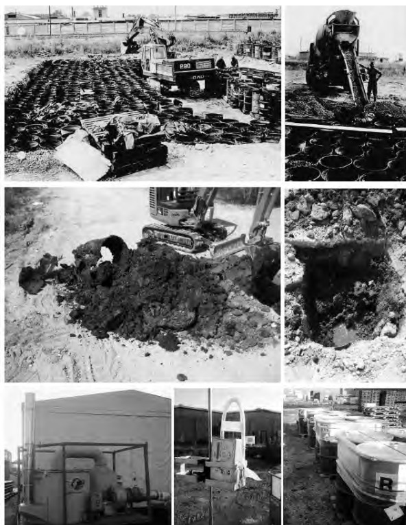
Fig. 2 - Vasche in area L - In alto: fusti con rifiuti inglobati nel calcestruzzo (1976). Al centro: deterioramento dei fusti e calcestruzzo ammalorato (2015). In basso: la tendostruttura con l'impianto di aspirazione forzata per creare un ambiente depressurizzato, i sistemi di monitoraggio dei vapori e il confezionamento dei rifiuti prodotti durante la bonifica e destinati allo smaltimento.
